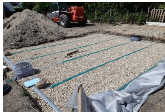
Photo 1 : Filtre à sable vertical non drainé
