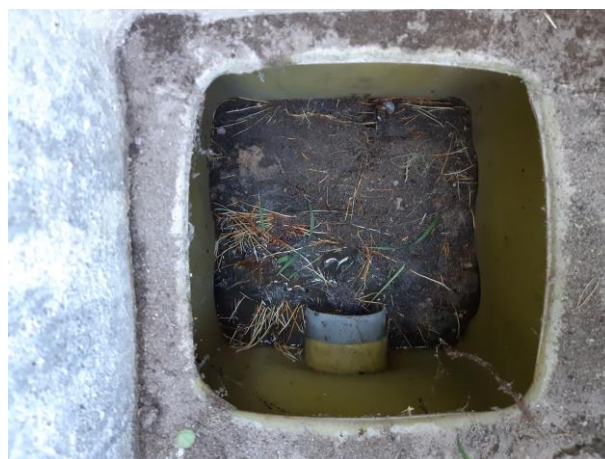
Photo 5 : Intrusion de racines dans une boîte de visite
