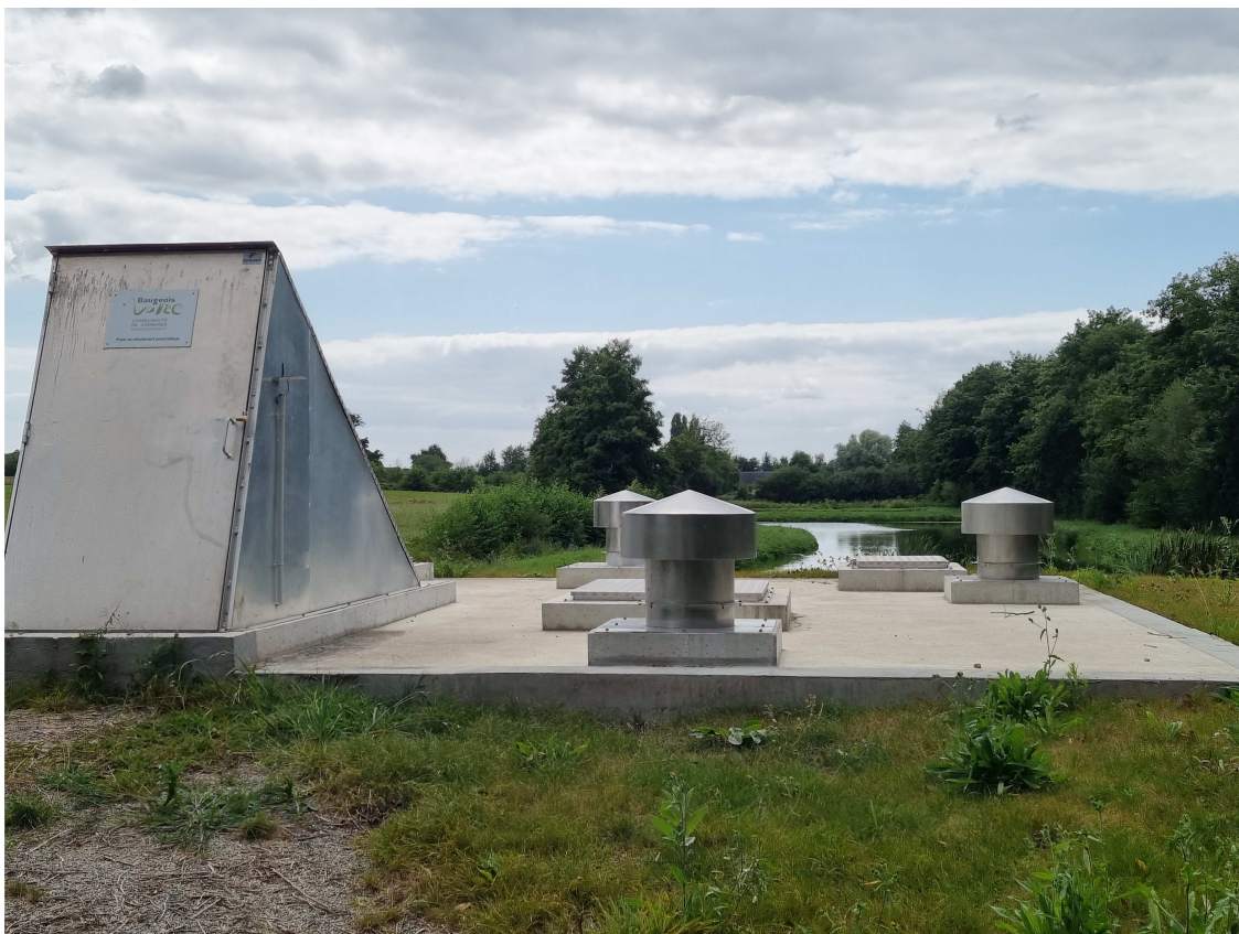
Poste de refoulement pneumatique, Echemiré
