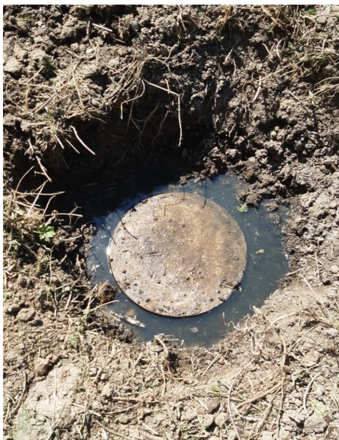
Photo 5 : Débordement d'eaux usées (risque sanitaire)
