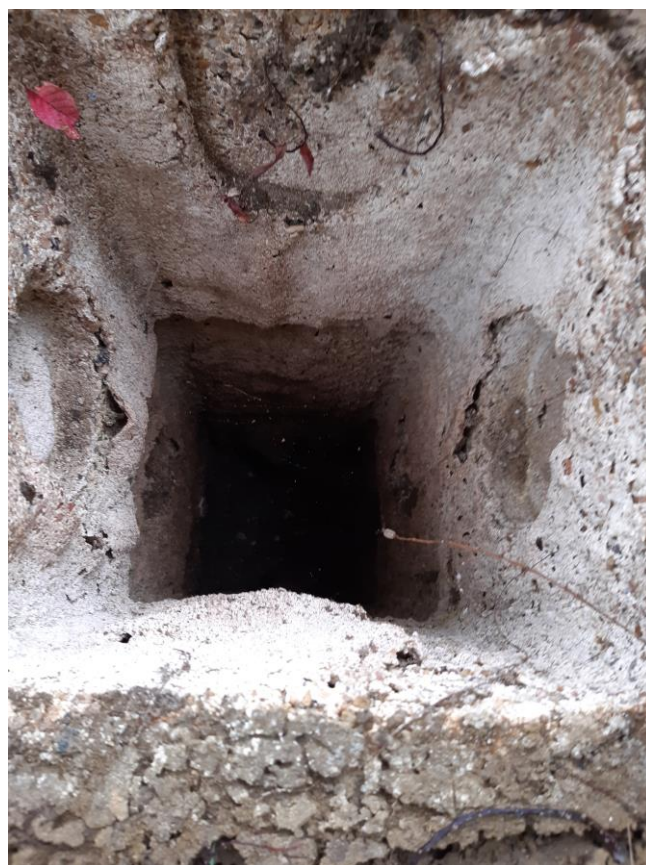
Photo 6 : boîte de visite corrodée
