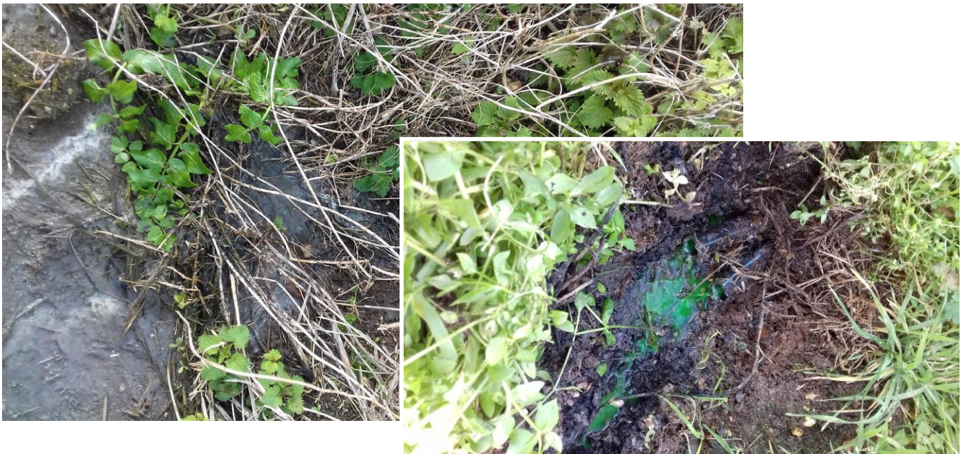
Photo 1 : rejet d'eaux usées non traitées au fossé (test au colorant sur la deuxième photo)
