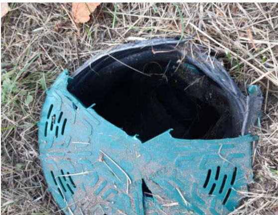
Photo 4 : Exemples d'ouvrages dégradés (fosses corrodées, préfiltre affaissé, couvercle de regard cassé)
