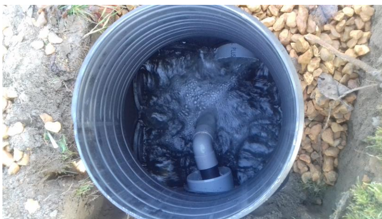
Photo 6 : Regard de répartition (arrivée des effluents via une pompe de refoulement)
