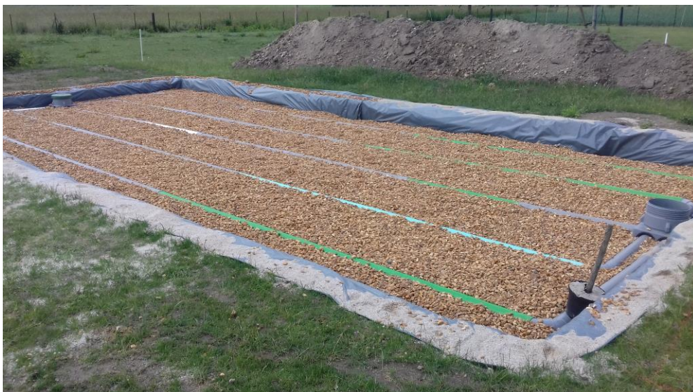
Photo 1 : Filtre à sable vertical non drainé
