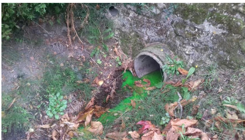
Photo 7 : Test au colorant (rejet direct d'eaux usées dans un fossé)
