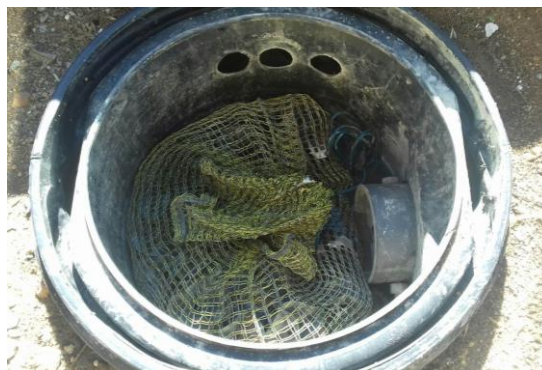
Photo 5 : Préfiltre intégré à une fosse toutes eaux
