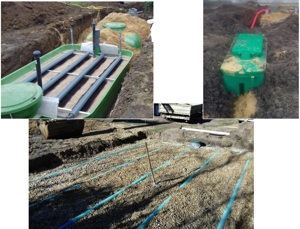
Photo 4 : Exemples de filières d'assainissement (filtre à massif de zéolithe, Tranchées d'épandage, microstation)
